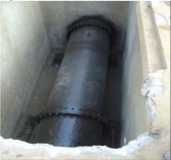
Sección de tubería para instalar medidor de caudal en EB N° 2
