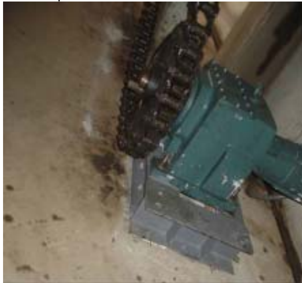
Motoreductor floculador Planta Convencional
