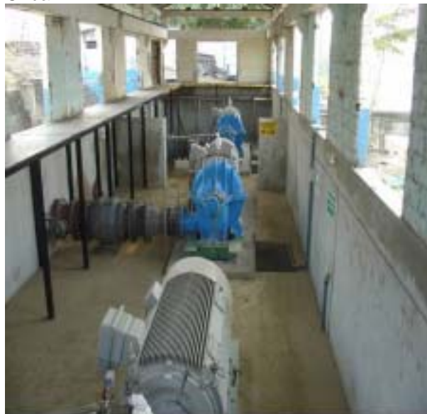
Detalle de la estación Elevadora de Agua Cruda N° 2, en operación
